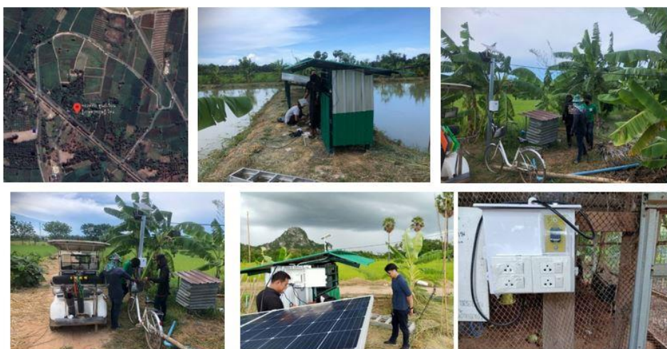
ภาพ : การใช้เครื่องกำเนิดไฟฟ้าพลังงานแสงอาทิตย์ภายในแปลง
